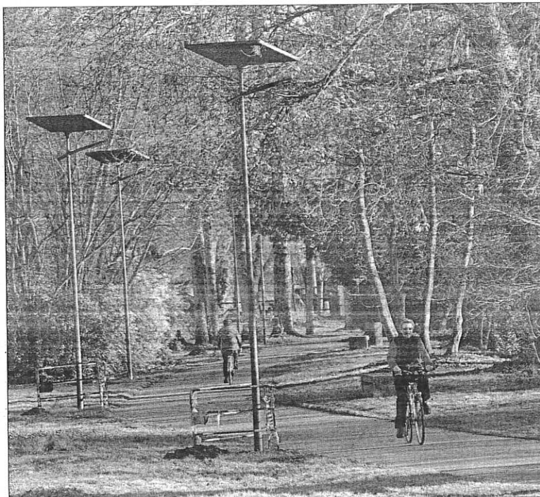
Les bornes défectueuses sont remplacées par des mâts solaires à LED. PHOTOS RÉMI PHILIPPON
